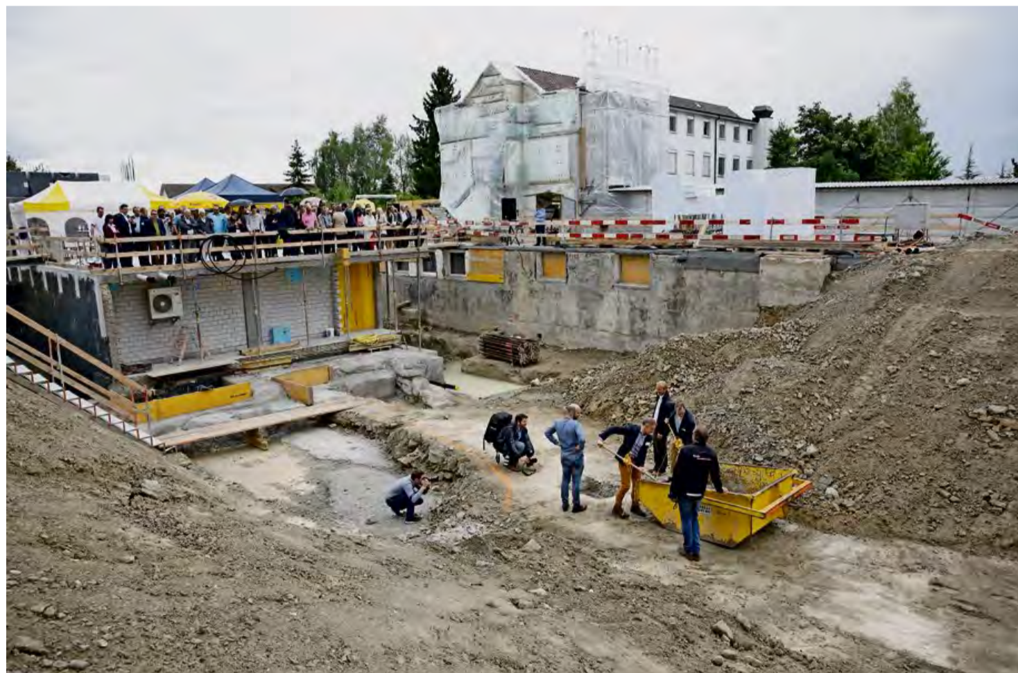
Tief unten ging es hoch her: In der Baugrube für den neuen Trakt der Klinik Schössli ist der Grundstein gelegt worden.
